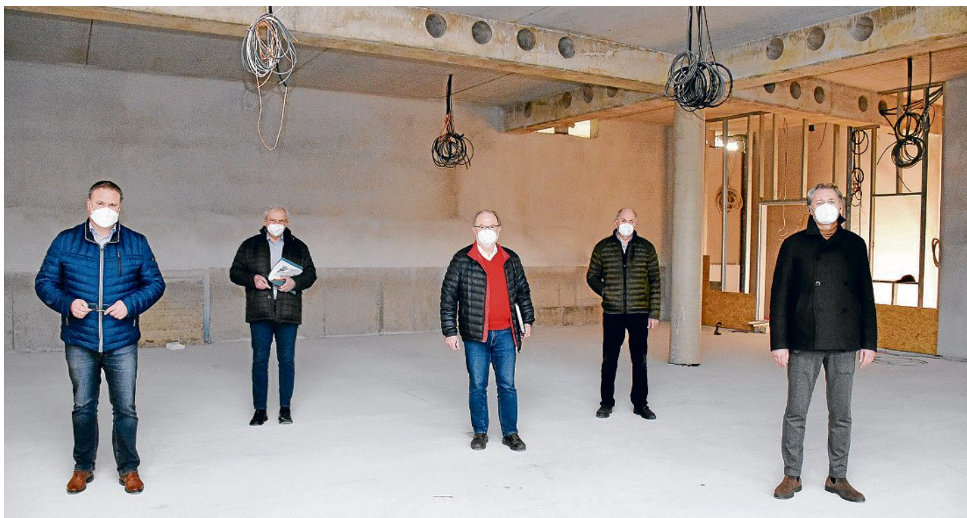
Besichtigungstour durch den erweiterten Rohbau: Über die Fortschritte beim Anbau an das Industriemuseum verschafften sich (von links) Tobias Gerdsmeyer, Benno Dräger, Bernard Lindemann, Alfons Sieverding und Michael Gerwing einen Überblick. Foto: Timphaus
